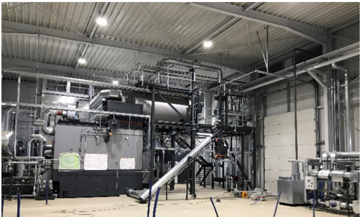
Blick auf die neue Anlagentechnik des Biomassezentrums II in Stausebach.
