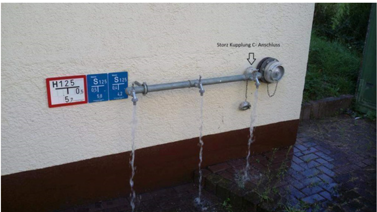
Gruppenzapfstelle im Betriebstest in einem Ortsteil von Weilburg.
