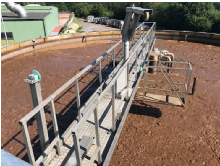
Belebungsbecken (biologische Reinigungsstufe) der betroffenen Abwasserbehandlungsanlage im Überlastungszustand.
