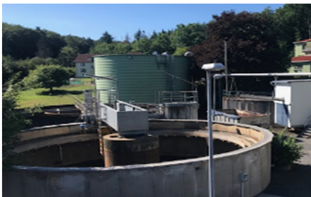
Gesamtansicht der betriebseigenen Abwasserbehandlungsanlage. © RP Gießen, mit freundlicher Genehmigung des Anlagenbetreibers
