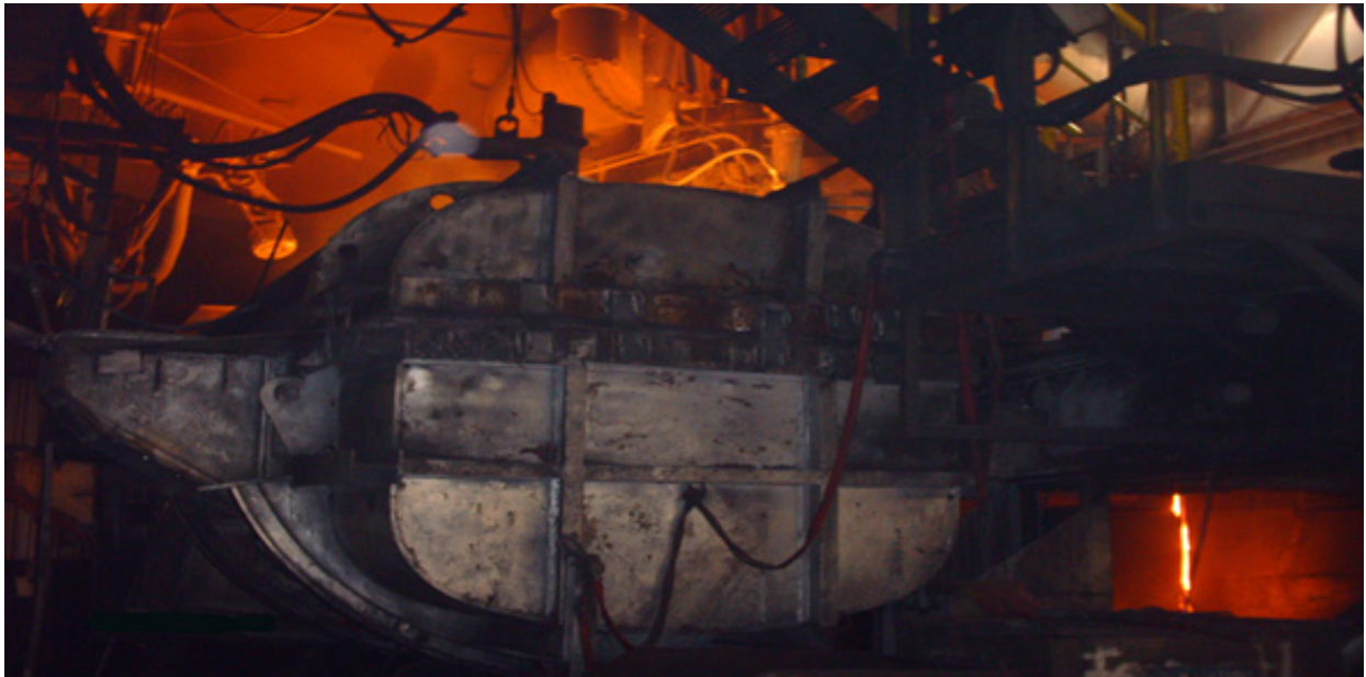
Warmhalteofen in der zentralen Schmelzanlage einer Eisengießerei.
