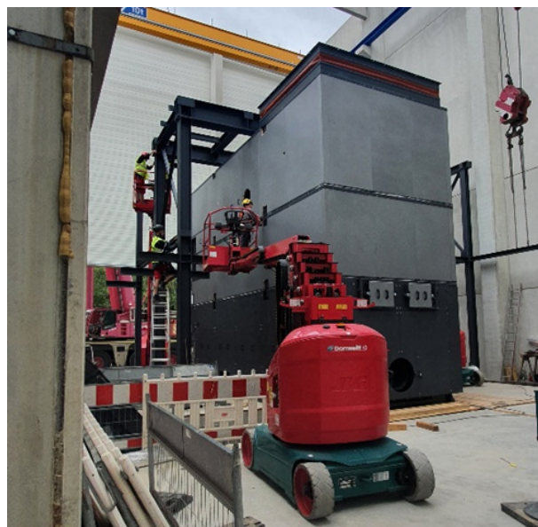
Brennkammer des neuen Biomasseheizwerks in Mittenaar-Bicken. © Furnier- und Holzwerk Mittenaar GmbH
